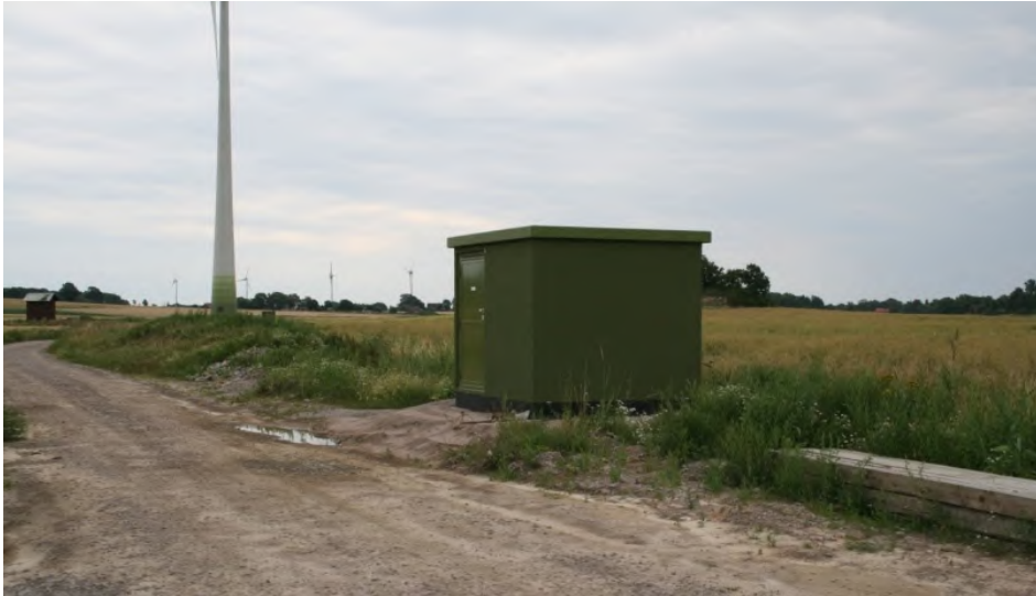
Exempel på transformatoriosk vid vindkraftverk.
