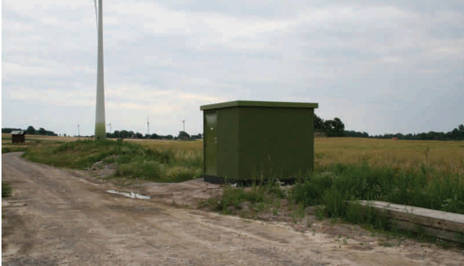
Transformatoriosk vid vindkraftverk
