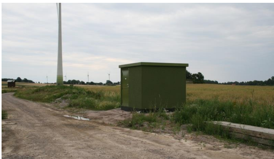
Transformatoriosk vid vindkraftverk
