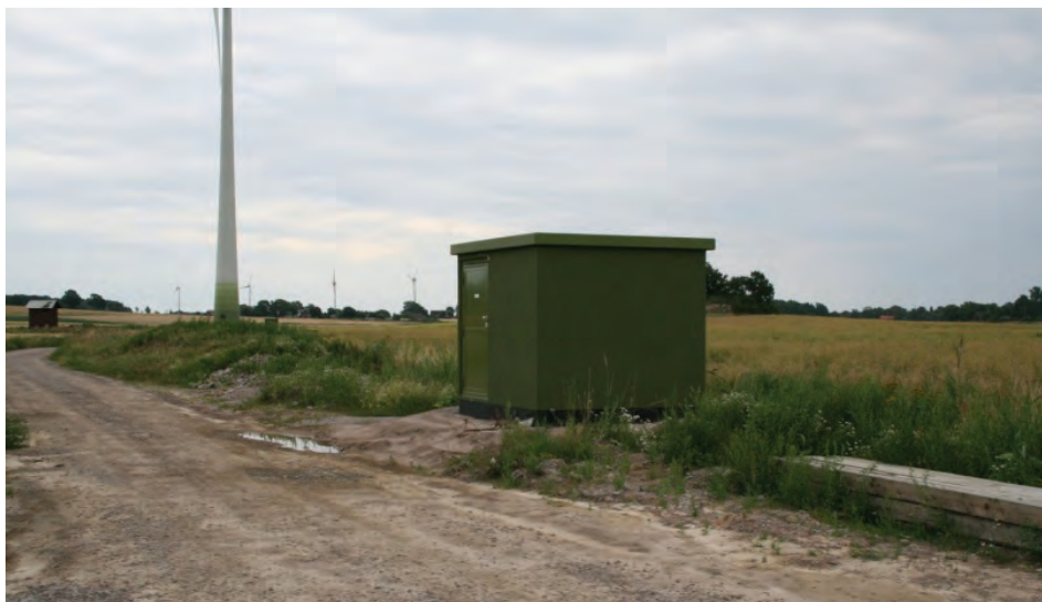
Transformatoriosk vid vindkraftverk
