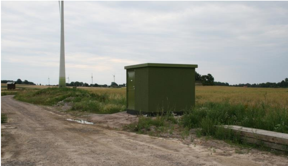
Transformatorbiosk vid vindkraftverk
