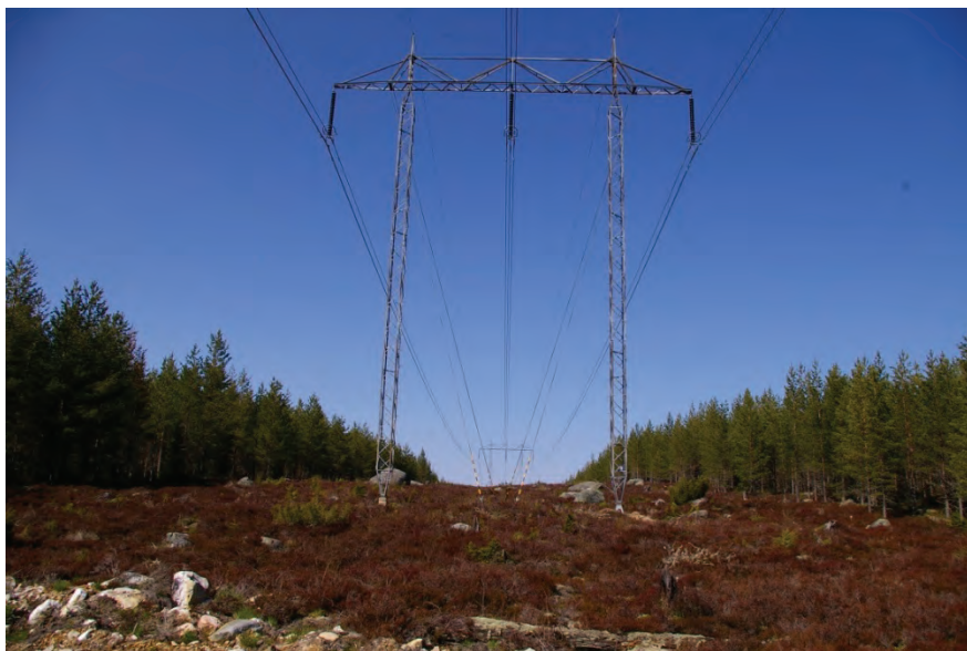
Figur 5-I. 400 kV ledningen på Broboberget vid den planerade transformatorstationen, foto wpd.
